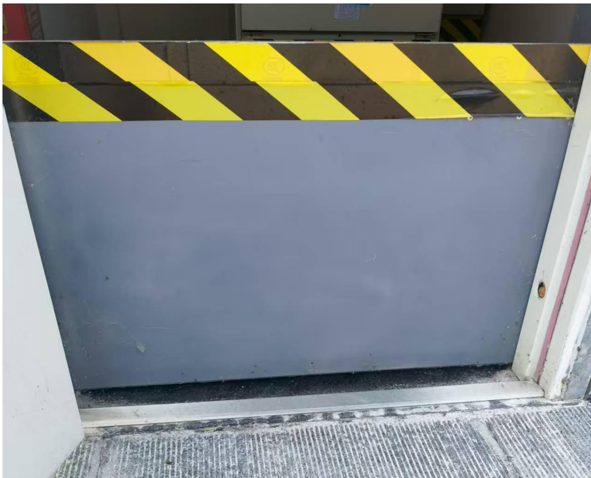
配电间已装设挡鼠板
